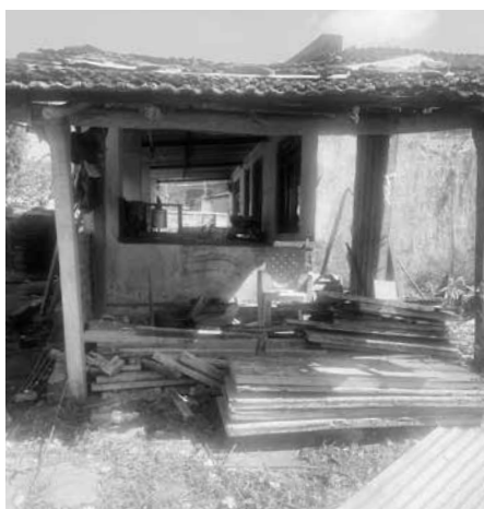
Das Haus der beiden unterstützten Personen befindet sich in schlechtem Zustand.
