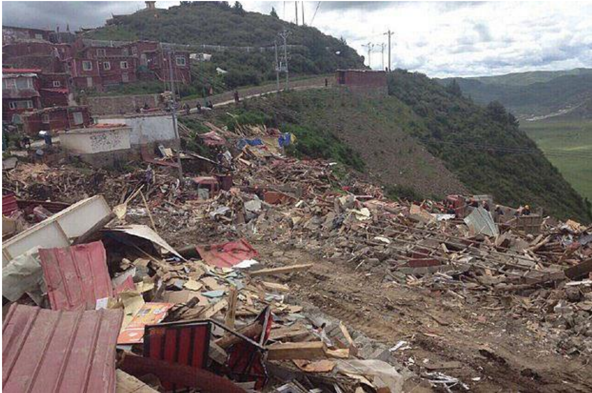
Und nach der Zerstörung (Quelle: RFA)
