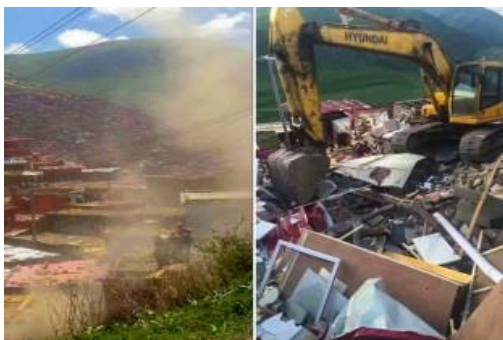
Wo früher Behausungen in Larung Gar standen, finden sich jetzt nur noch Trümmer (Foto: RFA)
